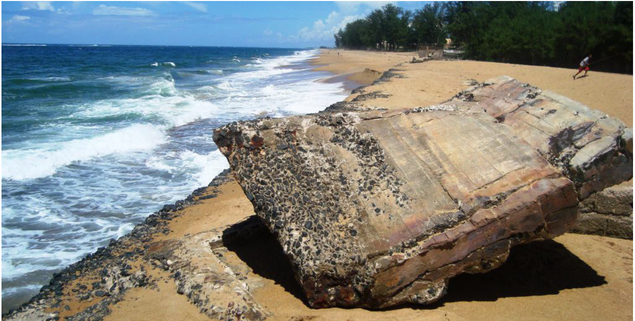
Destruction de la digue de protection de Manakara à cause de l'érosion marine.
