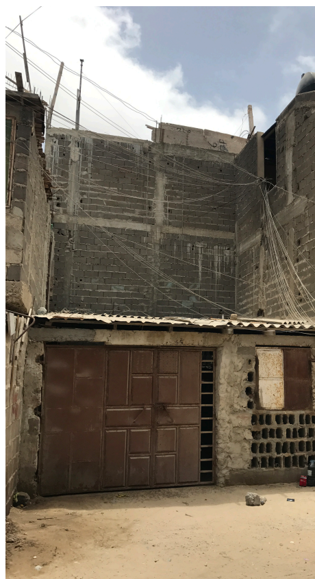
FIGURA 54. CASA COM GERADORES UTILIZADOS PARA PROVISÃO INFORMAL DE ELETRICIDADE EM SAL REI, ILHA DE BOA VISTA
