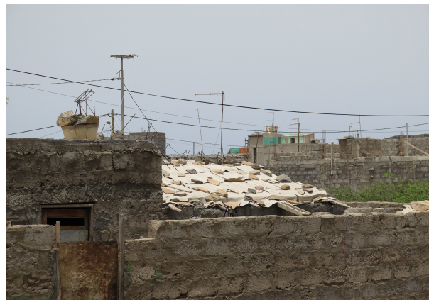
FIGURA 69.2. UTILIZAÇÃO DE PEDRAS PARA PROTEÇÃO DA COBERTURA, PORTO NOVO, ILHA DE SANTO ANTÃO. FONTE: ONU-HABITAT
