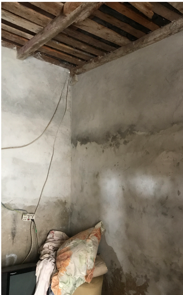
FIGURA 69.1. ELEVAÇÃO DE PAREDE DEVIDO À INFILTRAÇÃO SALINA NO PAVIMENTO, BAIRRO DA BOA ESPERANÇA, SAL REI, ILHA DA BOA VISTA. FONTE: ONU-HABITAT
