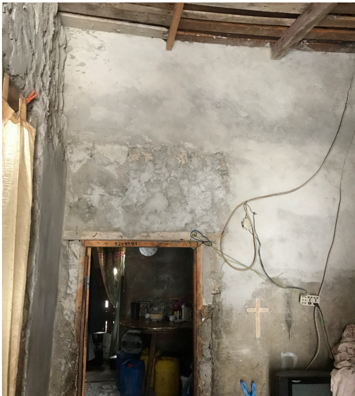
FIGURA 25.1. CONDIÇÕES DE PAREDES E REVESTIMENTO. FONTE: ONU-HABITAT
