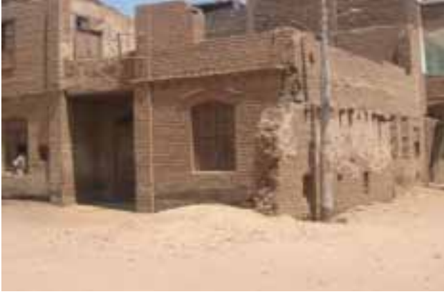
شكل (٢٣) المباني الرديئة بالمدينة
