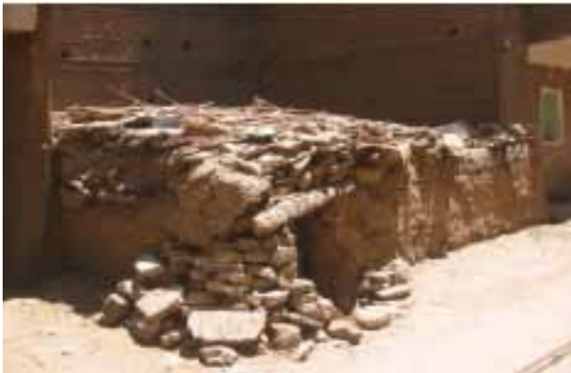
شكل (٢٢) المباني الرديئة بالمدينة
